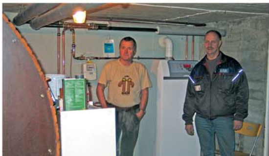
Sakari Turusen talosta vapautui rutkasti tilaa kondenssikattilan myötä. Vasemmalla vanha 4000 litran vesivaraaja.
